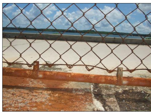
GS7:設置後約7年(撮影後張替)
