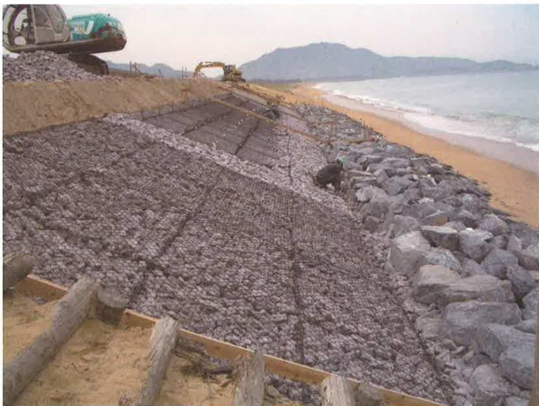
写真4 福岡県北九州 2006 (緩傾斜堤)
