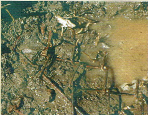
亜鉛めっき鉄線 7 種(S) 設置後約 8 年経過 赤さびが発生している為、設置当初の金網強度が維持できていない可能性が高い。また、腐食の影響で盛土との境界が識別しにくい。
