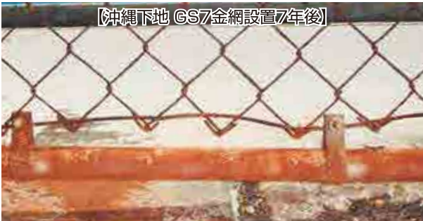
【沖縄下地島 GS7金網設置7年後】 金網の腐食が激しく胴縁ももらいサビが起きている。撮影直後の施工後7年で張り替えとなった。
