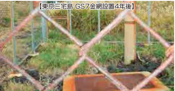
【東京三宅島 GS7金網設置4年後】 全面赤サビ発生。塩害地区より腐食が激しい様に見受けられる。施工後5年で張り替えとなった。
