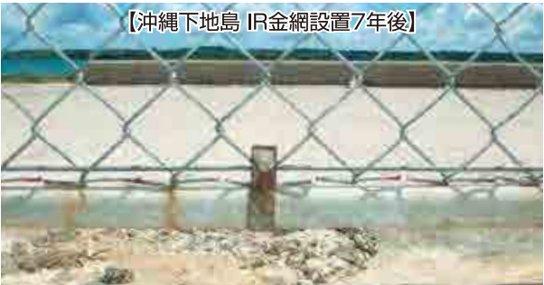
【沖縄下地島 IR金網設置7年後】 心線材が露出している端部は若干のサビが確認できるが、樹脂と心線材を完全接着しているため、端部からサビの進行は見受けられない。
