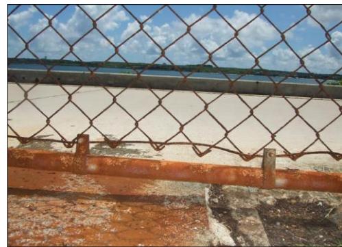
GS7:設置後約7年(撮影後張替)
