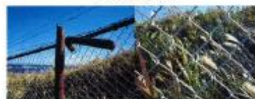
写真-2 海洋環境下に設置された IR 被覆鉄線の経年変化
